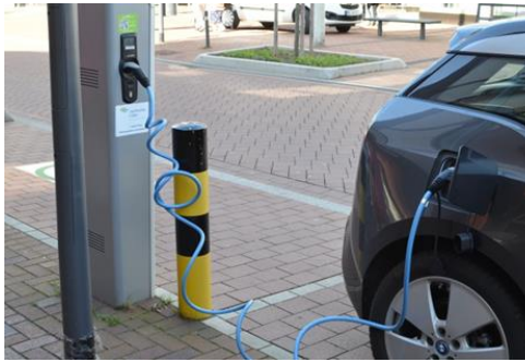
Abb. 5.6-6 E-Ladesäule während des Ladevorgangs 29
